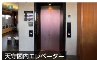
天守閣内エレベーター
