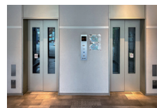
JO-TERRACE OSAKA エレベーター
